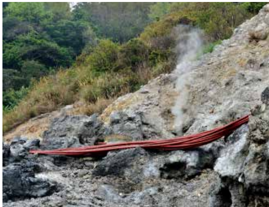
溫泉配管 Hot Spring piping
