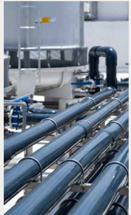
冷凍空調工程 Air Conditioning project
