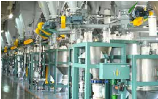
原料計量 Dosing equipment
